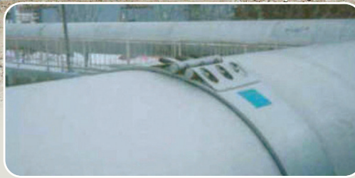
▲ 48" (1,200A) YN MF-RL Canadian power plant cooling line
